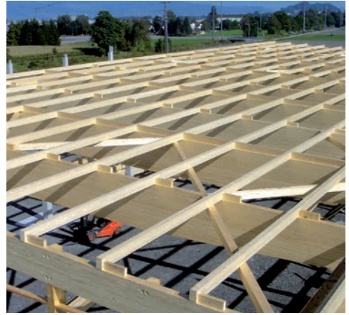
Fotos Wood Beton s.p.a., Roland Halbe Fotografie
